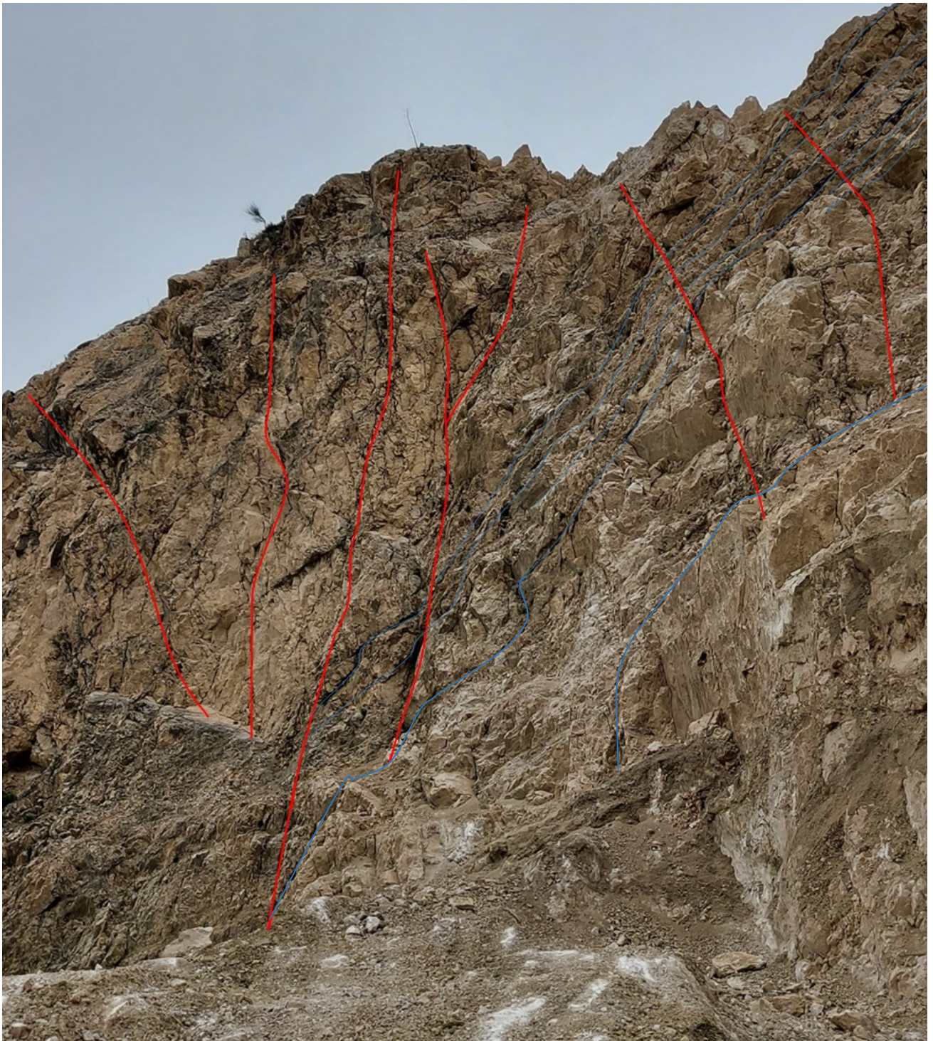
Foto n. 4 – Fascia cataclasata sulla parete occidentale a confine con le proprietà CECA - SEMAC, con strati a franapoggio visibili sul fronte della cava: la geometria del fronte e le caratteristiche strutturali dell'ammasso sono state derivate da rilievi di dettaglio operati in sito. In particolare, nel modello sono stati riprodotti due sets principali di discontinuità, quello subparallelo al fronte della cava e quello costituito dai giunti di stratificazione sub-orizzontali con giacitura a franapoggio. Inoltre, è stata altresì introdotta nel modello una direttrice di faglie sub-verticali, ubicate a pochi metri dal ciglio del fronte.
